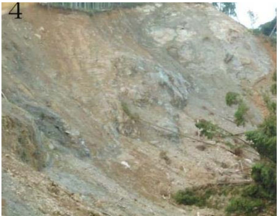
地すべり地上部にある崖 この崖の左側に頁岩，中央部と右側に玄武岩・玄武岩質凝灰岩がみられる。滑ったヴヴンは主として玄武岩・玄武岩質凝灰岩である。
