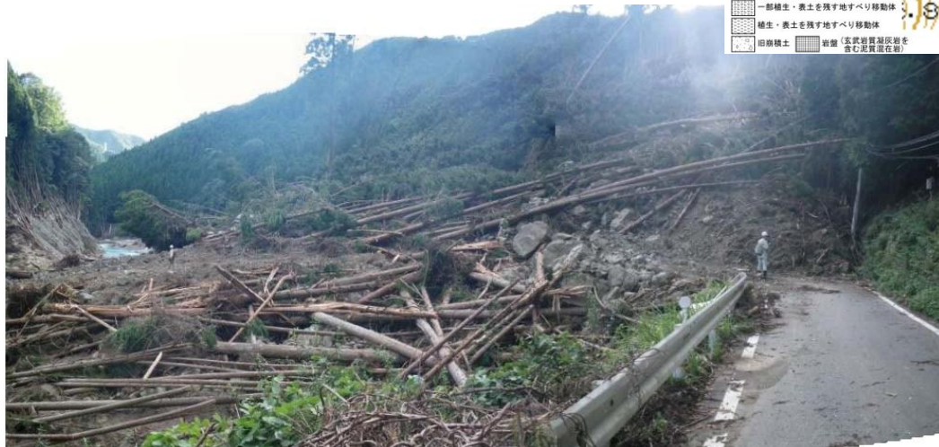
崩壊地末端部の状況 滑落土塊により県道は崩落・寸断されている
