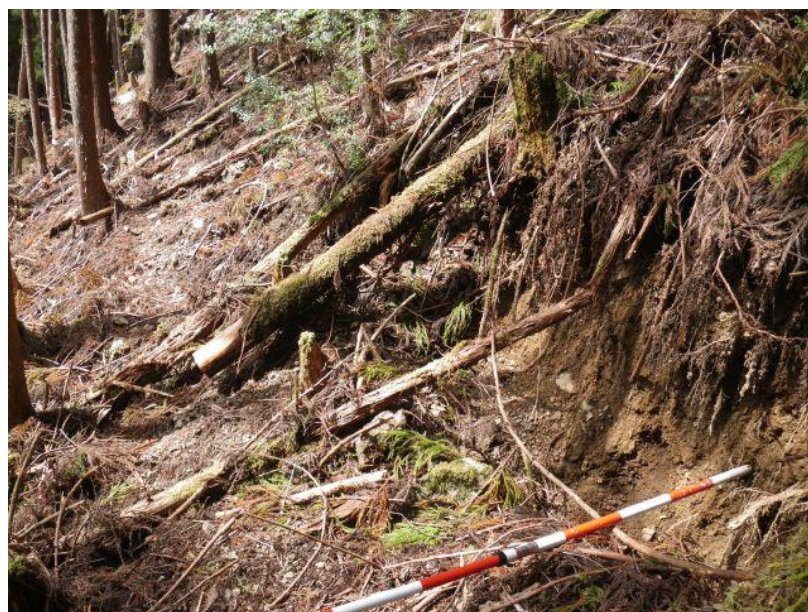
滑落崖上方の状況 表層には段差が連続して認められる
