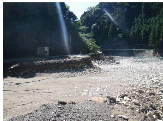
写真 4.1.6 対岸の洗掘状況
