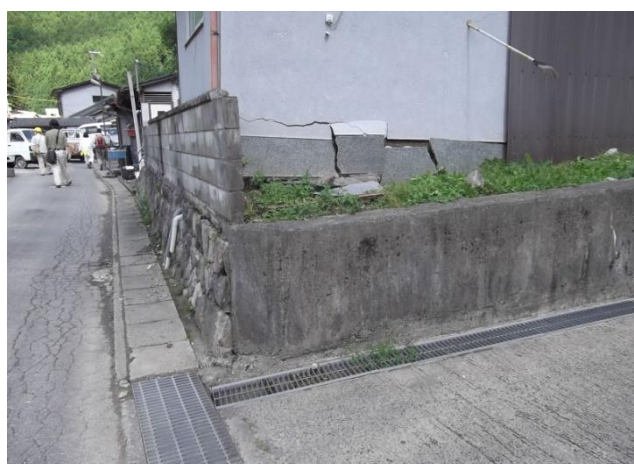
写真 4.5.6 水没家屋基礎部 (実質全壊状態)
