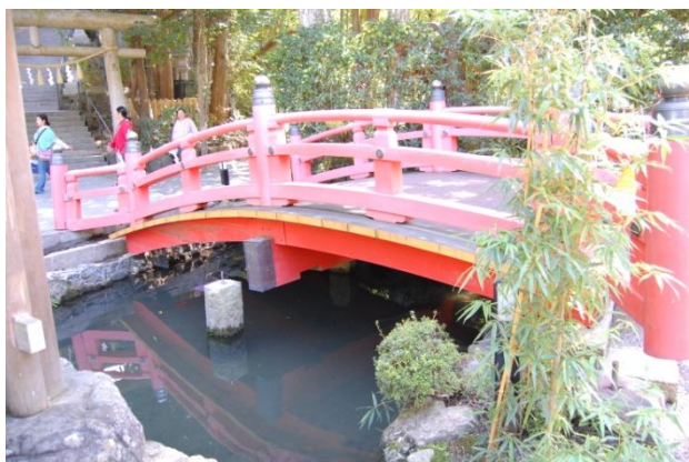
写真 4.5.8 天河大辨財天社 ずれた太鼓橋
