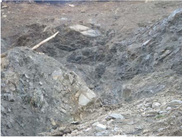
写真4. 15. 8 崩壊崖面に見られる岩盤の緩み
