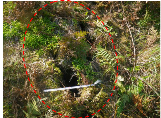
写真 4.1.7 滑落崖付近の地表面の開口亀裂
