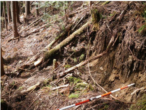
写真 4.3.2 滑落崖上部の地表の段差
