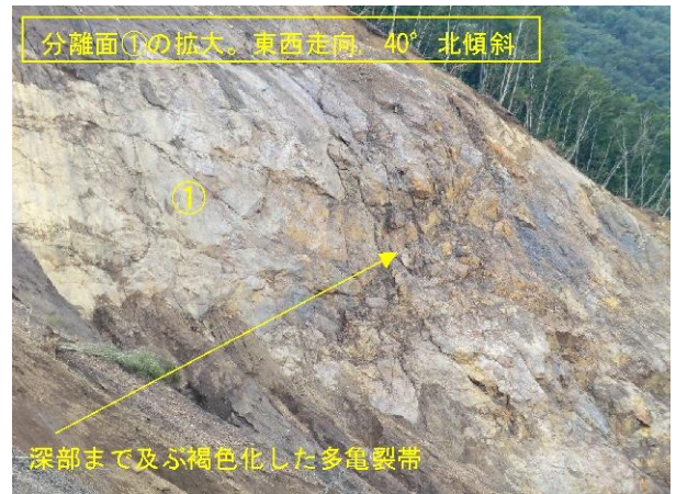
写真 4.9.3 滑落崖をなす分離面と深部まで及ぶ亀裂
