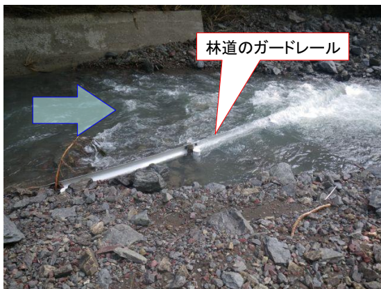
写真 4.2.8 埋没した林道
